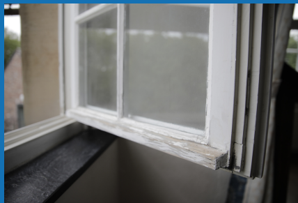
Vorher: Mehr als 30 in die Jahre gekommene, großflächige Fenster.
